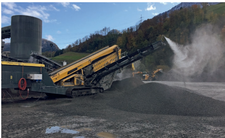
Düsenkränze aus Chromstahl befeuchten die Abwurfstellen der mobilen Siebanlage direkt da, wo der Staub entsteht.
