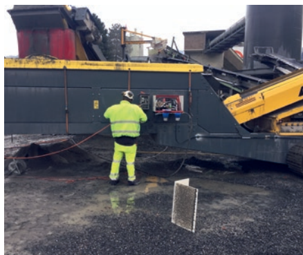
Die Spezialisten passen das Staubbindesystem individuell auf die Anlagen an, sowohl auf bestehende wie auch auf neue.
