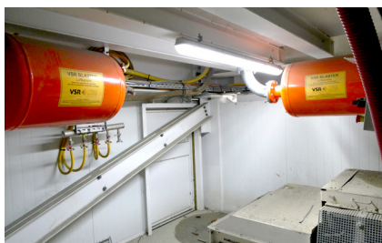
Les canons à air de 150 litres sont installés sous le silo.
