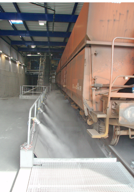
VSR-Dustex-Anlage bei der Flumroc AG: effiziente Staubbindung in räumlich begrenzten Einsatzgebieten mit Wasser und Druckluft. Fotos: zVg
