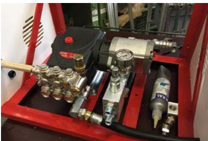
Die Pumpe ist hydraulisch angetrieben.
