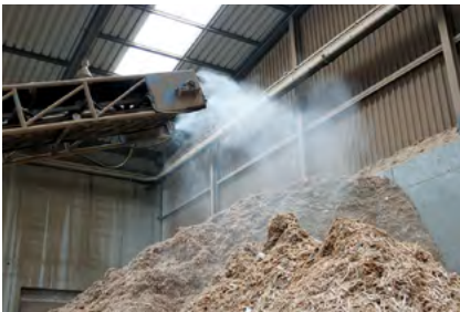
Die Bedüsung am Abwurfpunkt braucht wenig Wasser.
